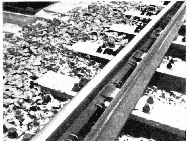
Bild 2: Elektrische Weichenheizung mit Heizstab. (Dieser wird durch Klemmen in der Randung zwischen Schienenfuß und -steg festgehalten)
