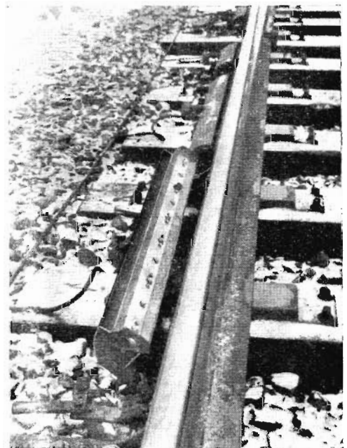
Bild 6: Geöffneter Heizkasten einer Propangas-Weichenheizung (mit Brenndüsen und Platinsündern)
