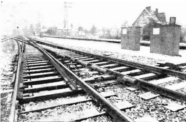
Bild 4: Gesamtanlage der Propangasheizung einer doppelten Kreuzungswiche mit den Heizkästen an den Schienen, (rechts zwei Flaschenschränke)
